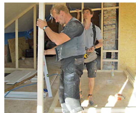
Ein arbeitsreiches „langes Wochenende“: Boden und Decke dämmen, Rahmen und Wände der Zimmer aufstellen.
